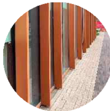
Отмостка выполнена из тротуарной плитки другого оттенка
